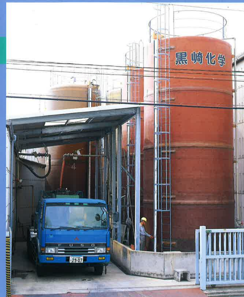
タンクヤード
